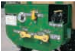
Центральная контрольная панель
