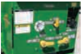
Центральная контрольная панель
